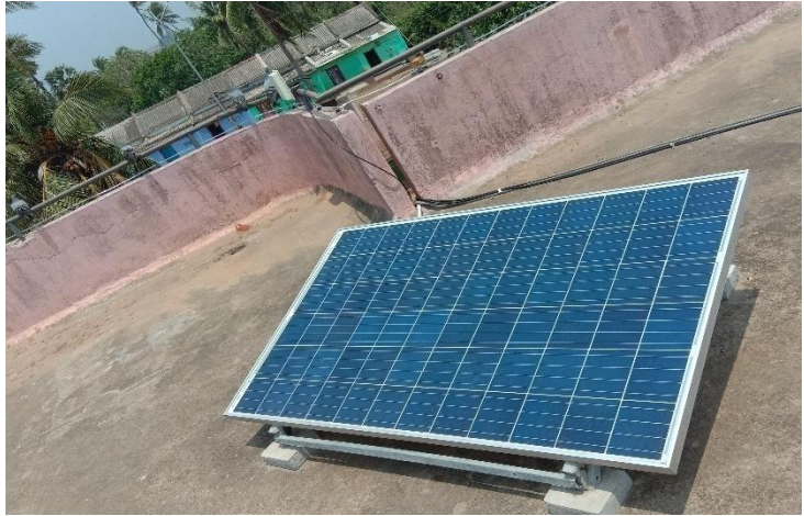
Solar PV module
